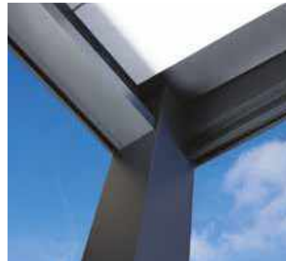
Wasserabfuhr von der Regenrinne direkt in den Stützpfeuern
