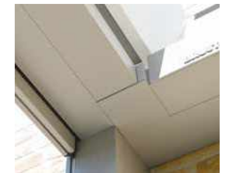
Wasserabfuhr von der Regenrinne direkt in den Stützpfeiler
